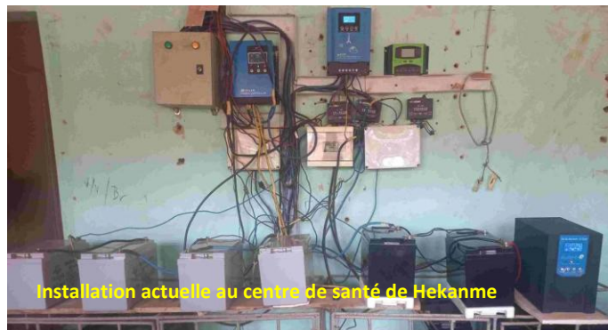
Installation actuelle au centre de santé de Hekanme
