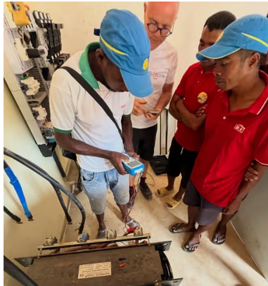
Utilisation du contrôleur d'isolement
